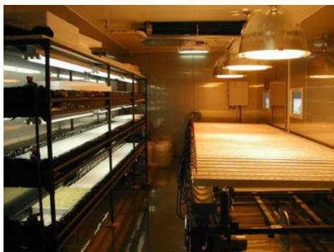
H16～H26まで稼働した植物工場内
